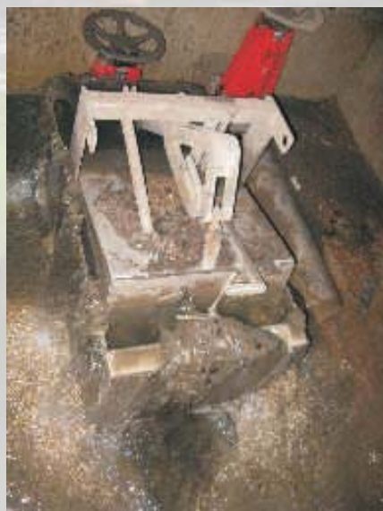
Zadrževalni bazen ZB ZD (križišče na Savinjski cesti) Zamašitev s krpami in vlažilnimi robčki
