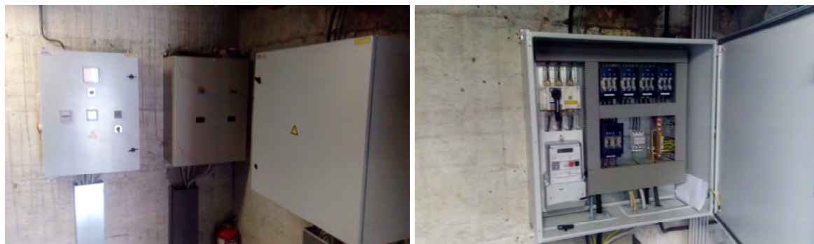
Nova elektro omara v črpališču Škratovina
