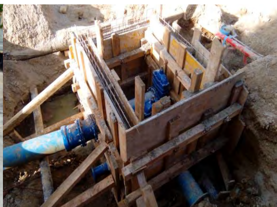
Cevovodno vozlišče v jašku na Opekarni
